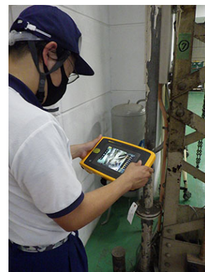
エアーリーク調査の様子
